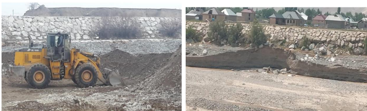
Рис.1. Последствия добычи ПГС на пойме реки Кугарт в районе с. Благовещенка, приводящая к разрушению берегозащитной дамбы.
